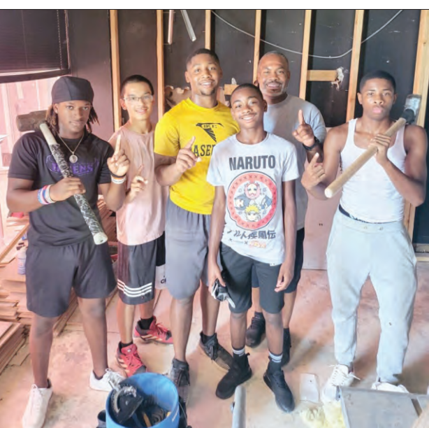
Zacchaeus Henry y un grupo de estudiantes trabajando en el proceso de remodelación de la barbería.
